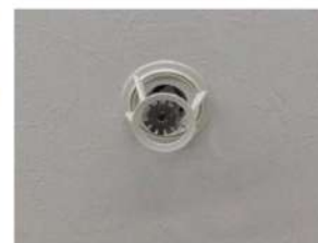
天井に付けられたスプリンクラー
